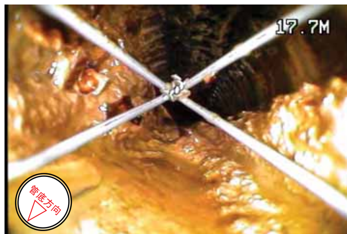
暗渠管内の土砂堆積状況
