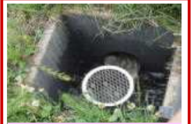
用水路と暗渠排水を接続する「集中管理孔」
