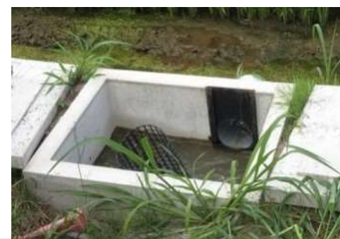
用水路と暗渠排水を接続する「集中管理孔」
