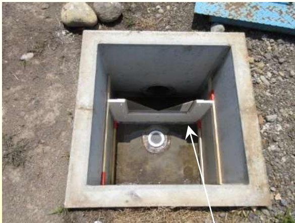
集中管理孔 (流量測定用の三角堰を設置)
