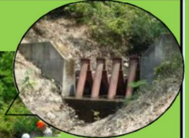
流木等を捕捉する 治山ダム(スリットダム)
