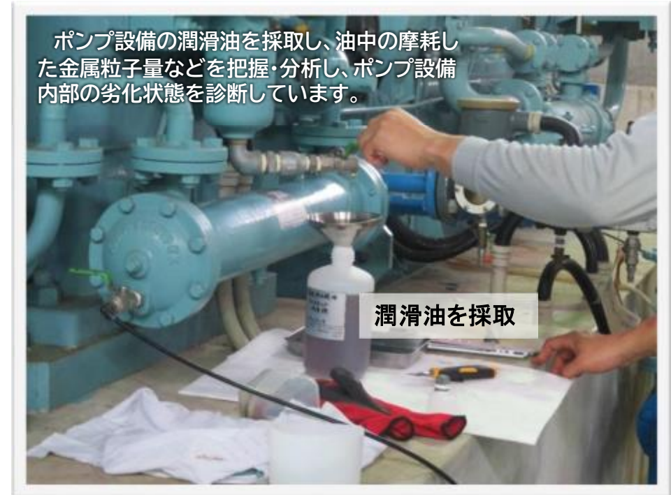
【豊幌排水機場(岩見沢市)のポンプ設備内の潤滑診断調査】
