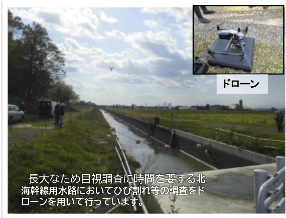
【ドローンを活用した北海幹線用水路(岩見沢市)の機能診断】
