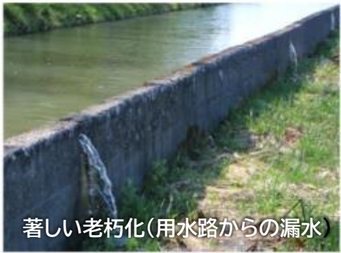
【農業水利施設(用水路)の整備】
